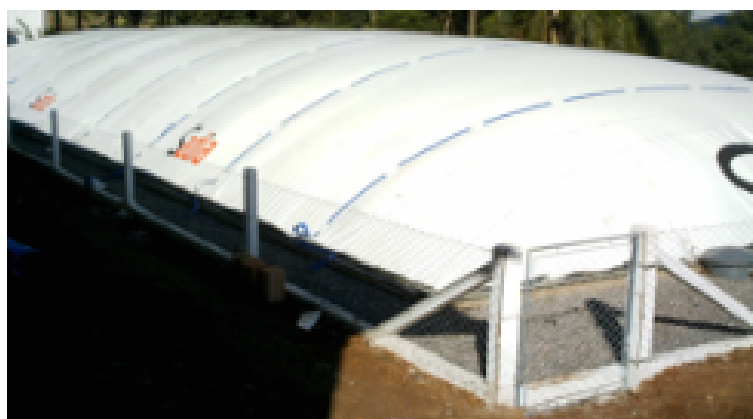
Figura 6. Projeto Biodigestor finalizado
