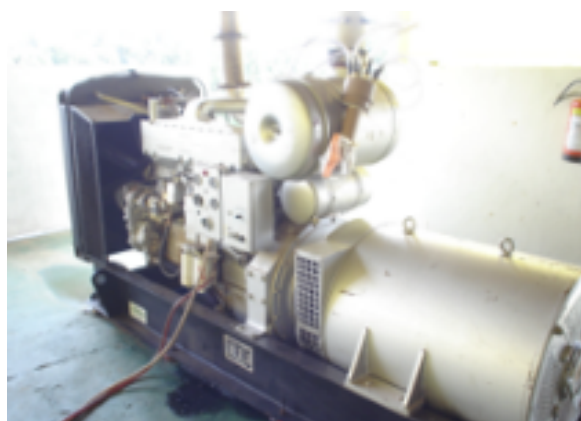
Figura 7. Gerador de Energia Elétrica
