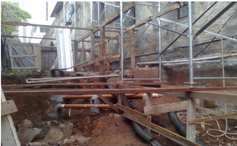
Figura 1. Apoio das sapatas do andaime.
