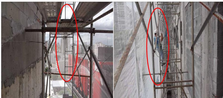
Figura 4. Escada incorporada ao andaime e ato inseguro.
