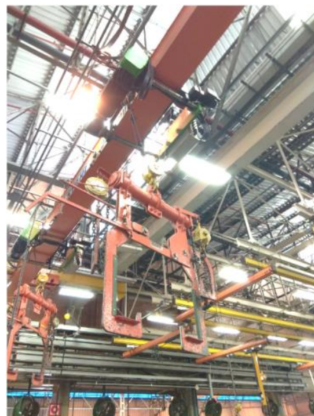
Figura 09 – Ponte rolante de transferência
