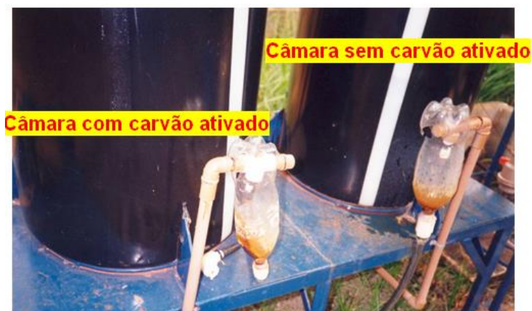
Figura 6. Detalhe do conjunto de filtros lentos
