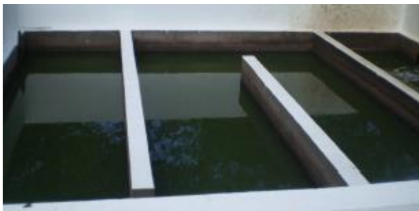
Figura 4 – Vista do tanque de contato (SABESP, 2011).
