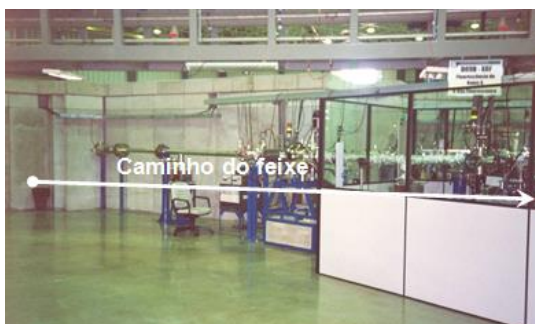
Figura 10: Foto da tubulação do anel para a linha DO9B – XRF do Laboratório Nacional de Luz Síncrotron, por onde passa o feixe de luz síncrotron.
