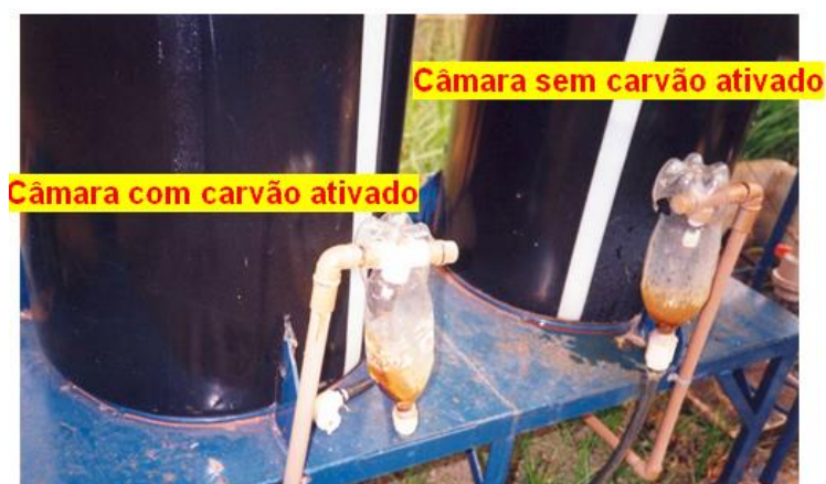
Figura 8: Detalhe do conjunto de filtros lentos.
