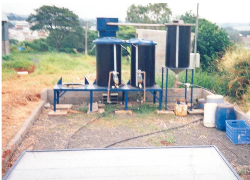
Figura 2: Vista da estação de filtro lento da FEAGRI.
